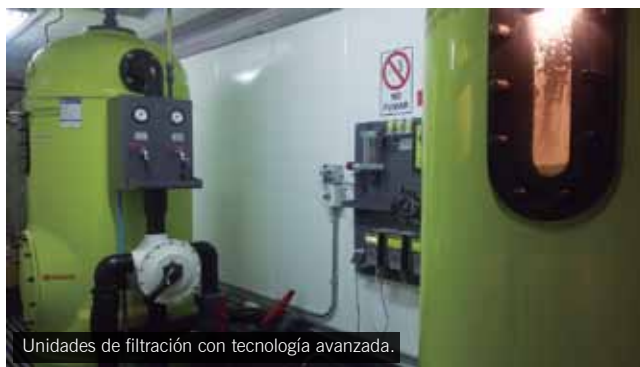
Filtro con 4 válvulas de vías incorrecto.
